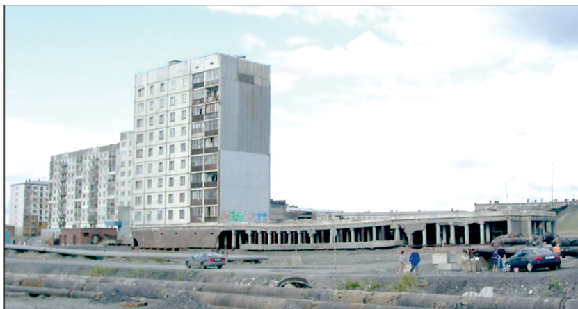
Рис. 8. Норильск. Деформированный криогенными процессами фундамент разобранных секций 9-этажного здания (фото Д.С. Дроздова)
