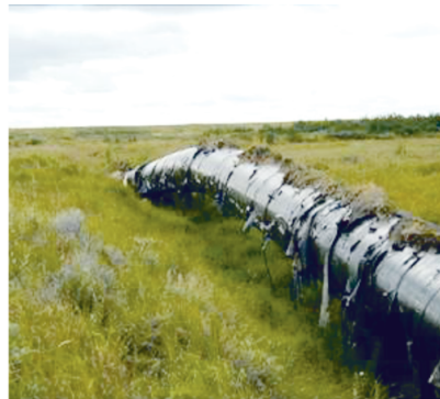
Рис. 7. Выпучивание трубопровода с последующей осадкой поверхности под ним
